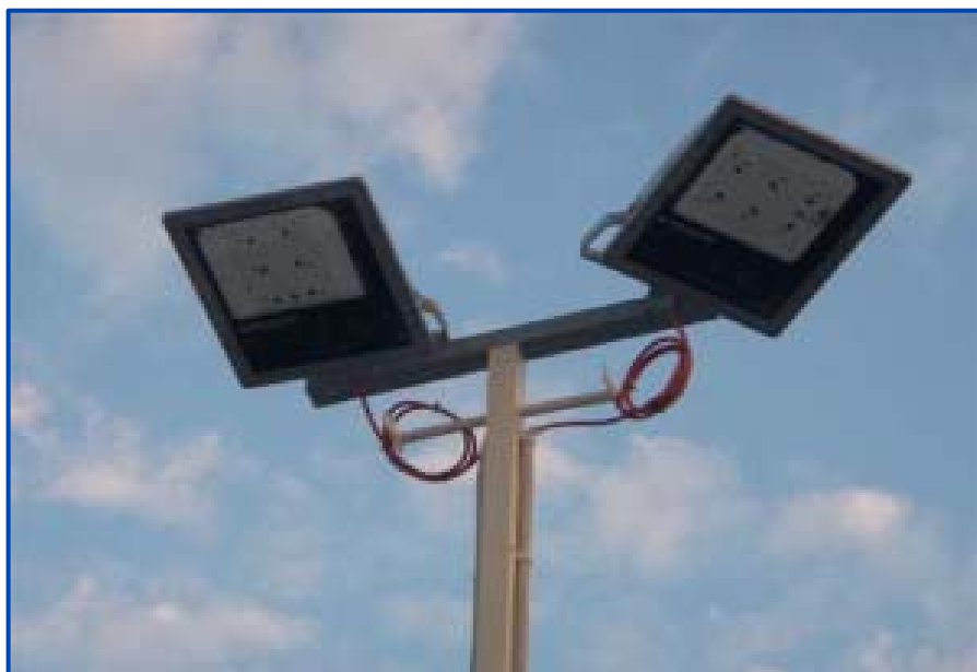
Figur 9 Exempel på modern områdesbelysning med LED-teknik (foto: RBM Company)
