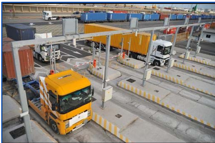
Figur 8 Installation vid hamnterminal för registrering av fordons registreringsnummer och containernummer (foto: Orbita Ingeniería, S.L.)
